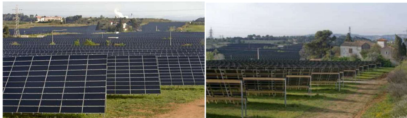
Photo 62 : Illustrations montrant le développement de la végétation sous les panneaux photovoltaïques
