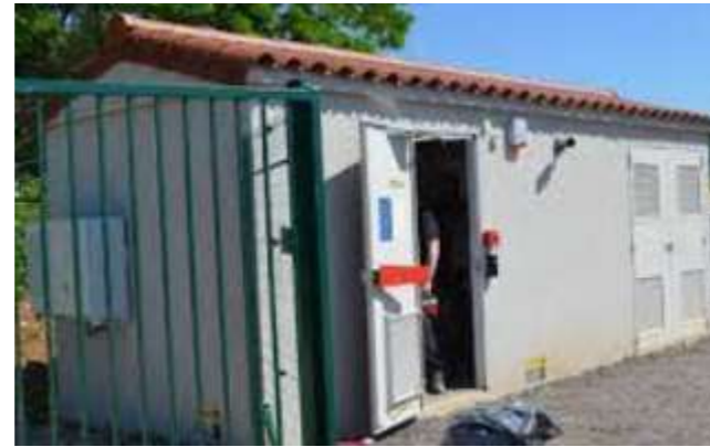
Figure 45 : Exemple de Poste de Livraison (Source : internet)
