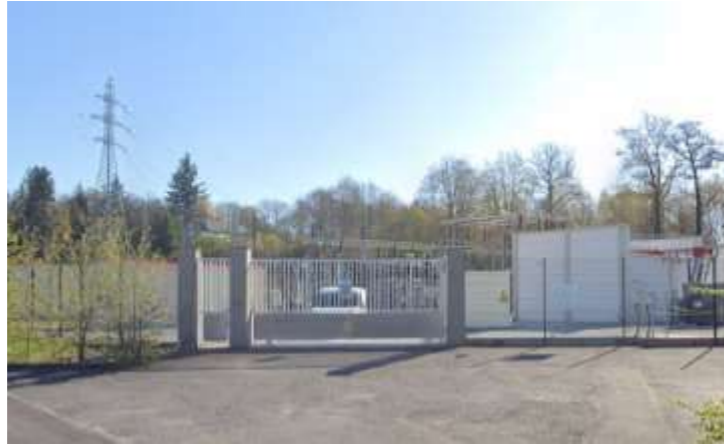
Photo 74 : Poste source de Peyrilhac Source : Oxynergie
