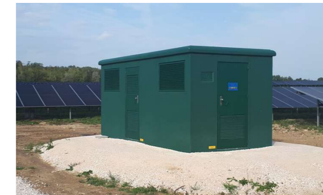
Figure 44 : Exemple Poste de Transformation (Source : Oxynergie)
