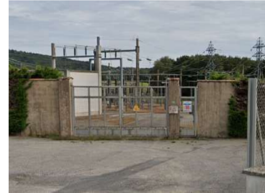
Photo 76 : Poste source d'Ambazac Source : Oxynergie
